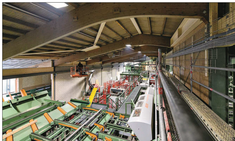
2019 wurden ein Sortierwerk mit Stapelanlage und eine Keilzinkanlage installiert.
