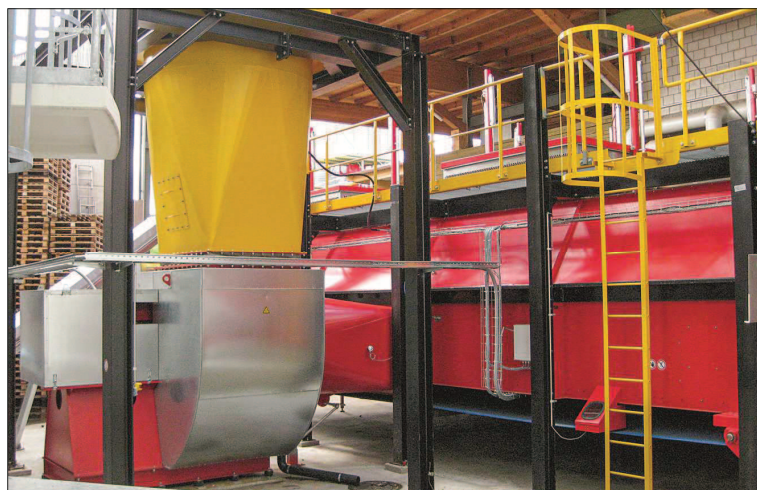
Einer der beiden Bandtrockner von Swiss Combi wurde von 60 auf 88 m 2 Trocknungsfläche erweitert. Die Kapazität wurde damit von 3 t/h Trockenprodukt auf 4,6 t/h erhöht. Foto: Swiss Combi
